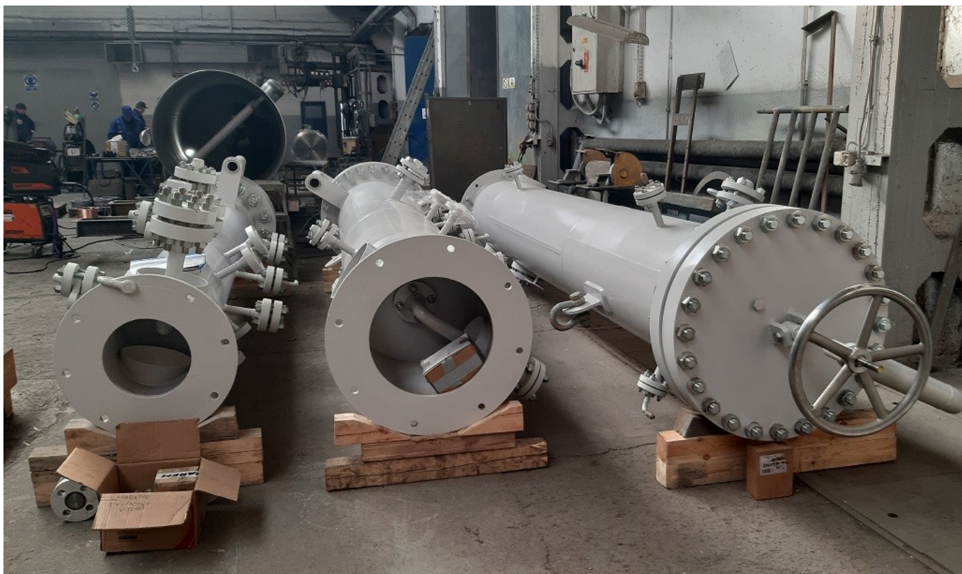
Separatory wstępne gazu i kolumna adsorpcyjna par rtęci
