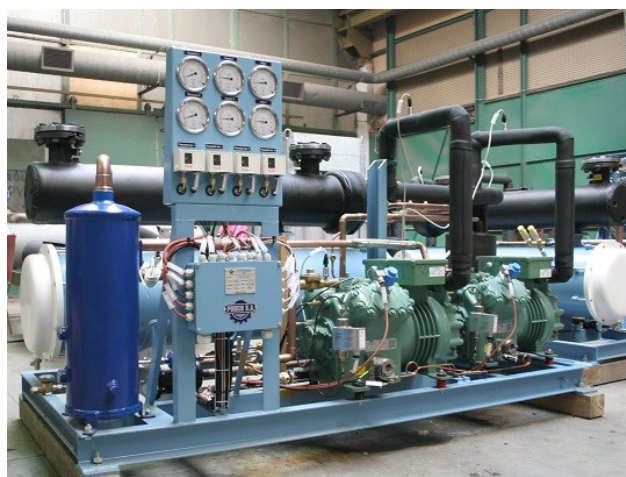
Agregat wody lodowej do klimatyzacji Zodiaka II
