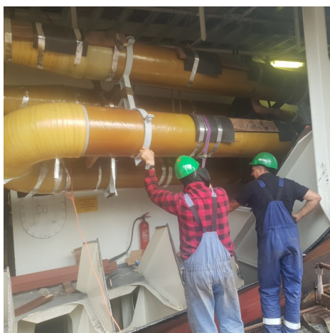
Instalacja z rur GRE
